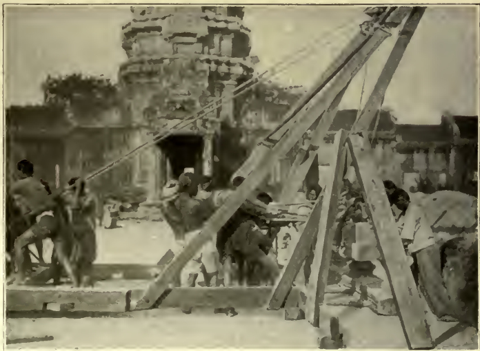
ANGKOR-VAT. — INDIGÈNES TRAVAILLANT A LA RESTAURATION DE LA BALUSTRADE DE LA CHAUSSÉE DALLÉE.
